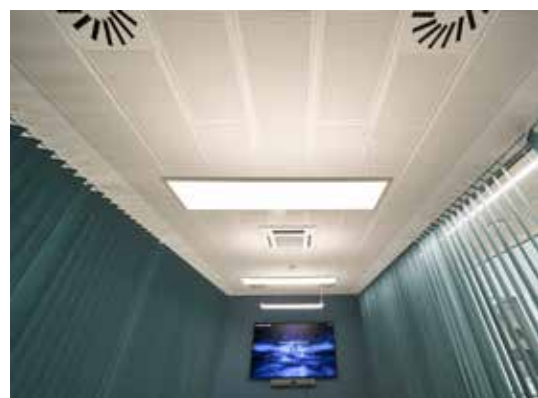
ELEGANZ. Die Metallkassettendecke in den Büros überzeugt mit akustischer und klimatechnischer Qualität.
